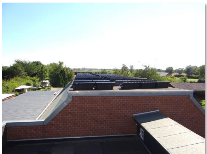
Dach Halle und Gewerbefläche mit Photovoltaikanlage
