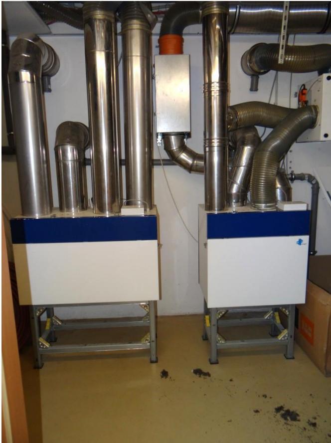
Kontrollierte Be- und Entlüftungsanlage
